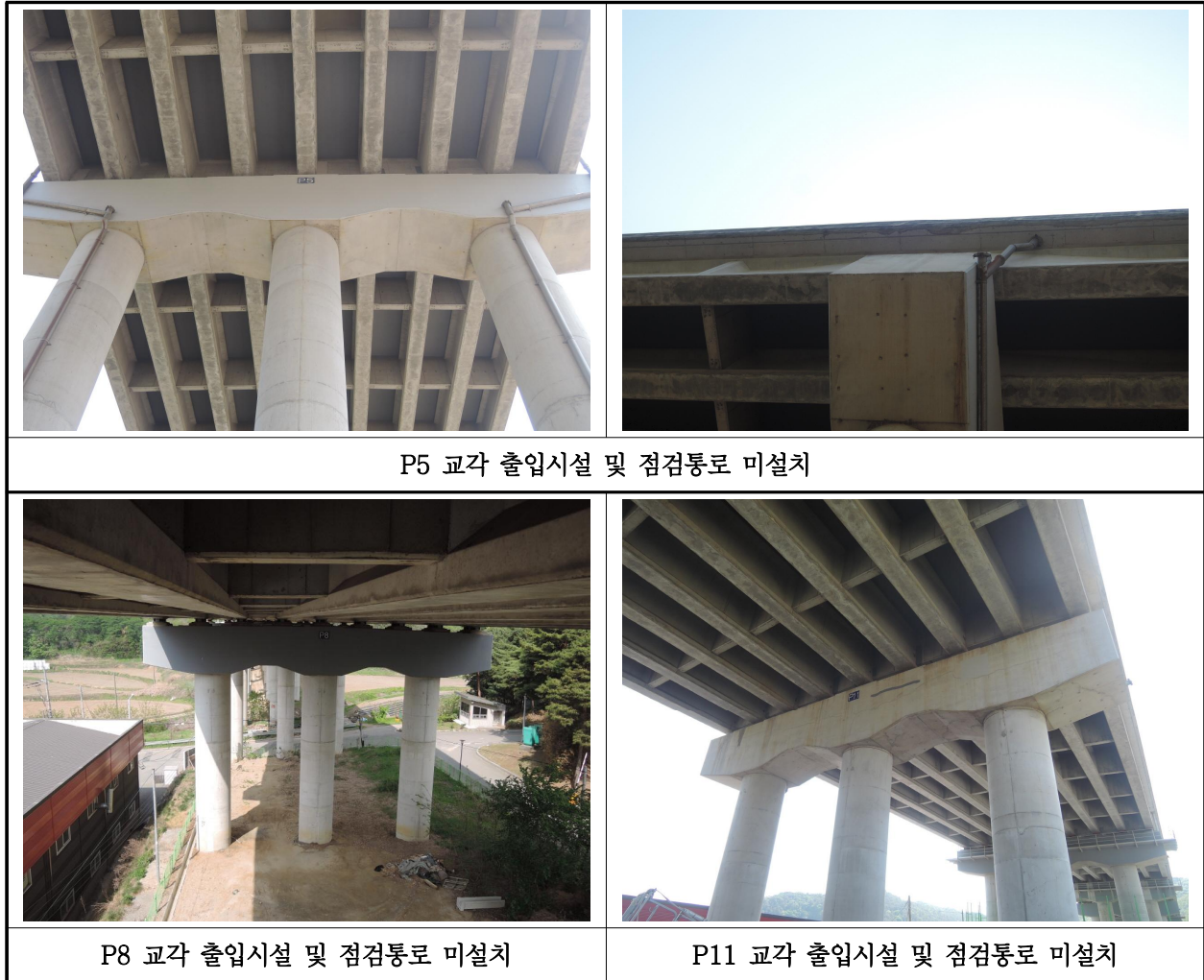
【사진 3.3.23】 교량 점검시설 손상현황
